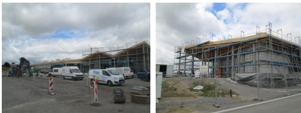
Am südöstlichen Siedlungsrand des Gäufelder Stadtteils Nebringen ist die Realisierung eines Nahversorgungsstandortes vorgesehen. Hier entsteht ein Edeka-Supermarkt mit ca. 1.500 m 2 VK sowie ein Drogeriemarkt mit ca. 600 m 2 VK. Die Bauarbeiten sind bereits weit fortgeschritten.
